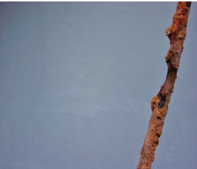
图2 被腐蚀50%以上的情况
