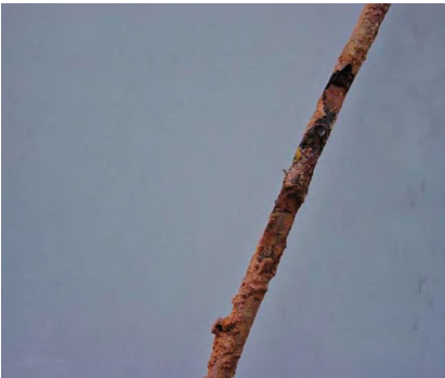
图1 电缆沟内接地腐蚀情况
