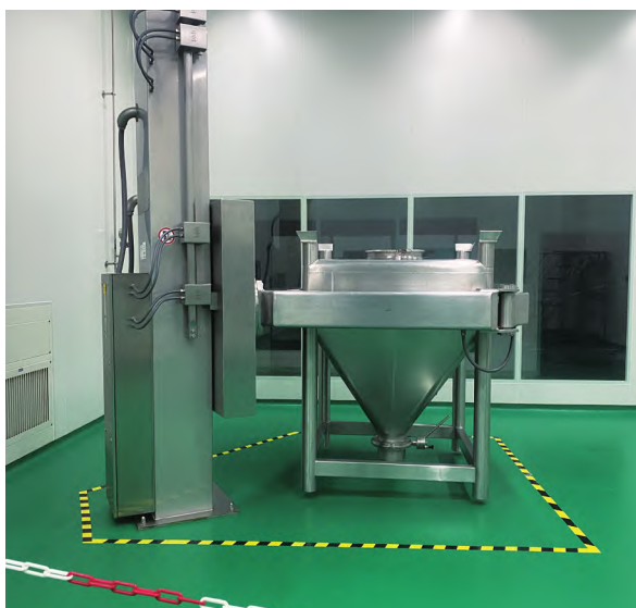
图2 固体制剂车间混合间的循环型空调系统
