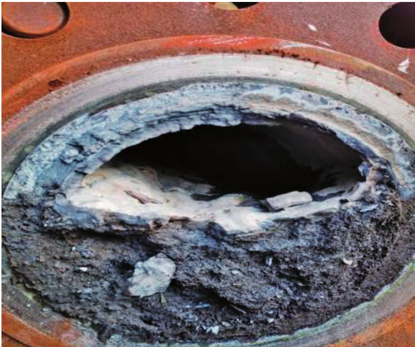
图 5 拆检后的气化炉排水管线堵塞情况
