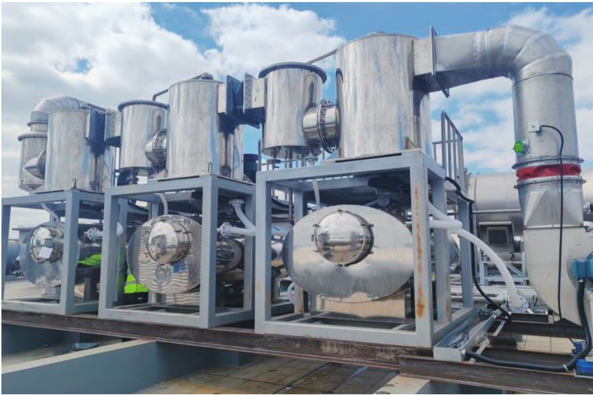
图 2 卷烟厂超重力装置现场
