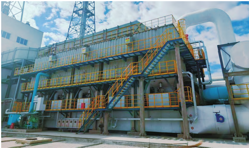
图 1 RTO 装置区现场图
