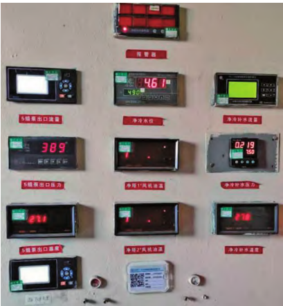
图3 原现场监控现状
