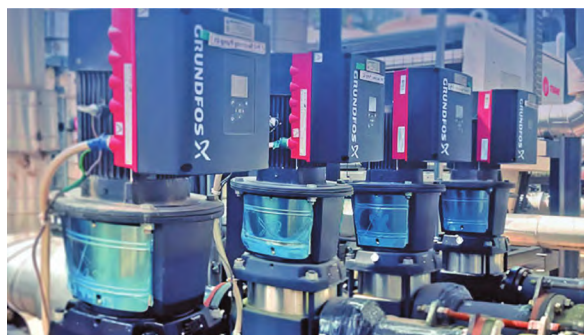
图 5 格兰富水泵被安装在博世印度的水冷系统中
