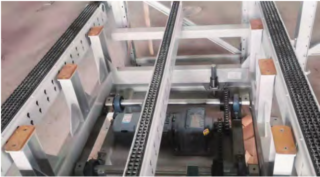
图 7 “田字底”托盘在“链条机 + 顶升台”方式输送系统中的应用
