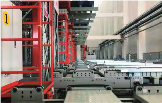
图 6 “田字底”托盘在链条机插取位断链方式输送系统中的应用
