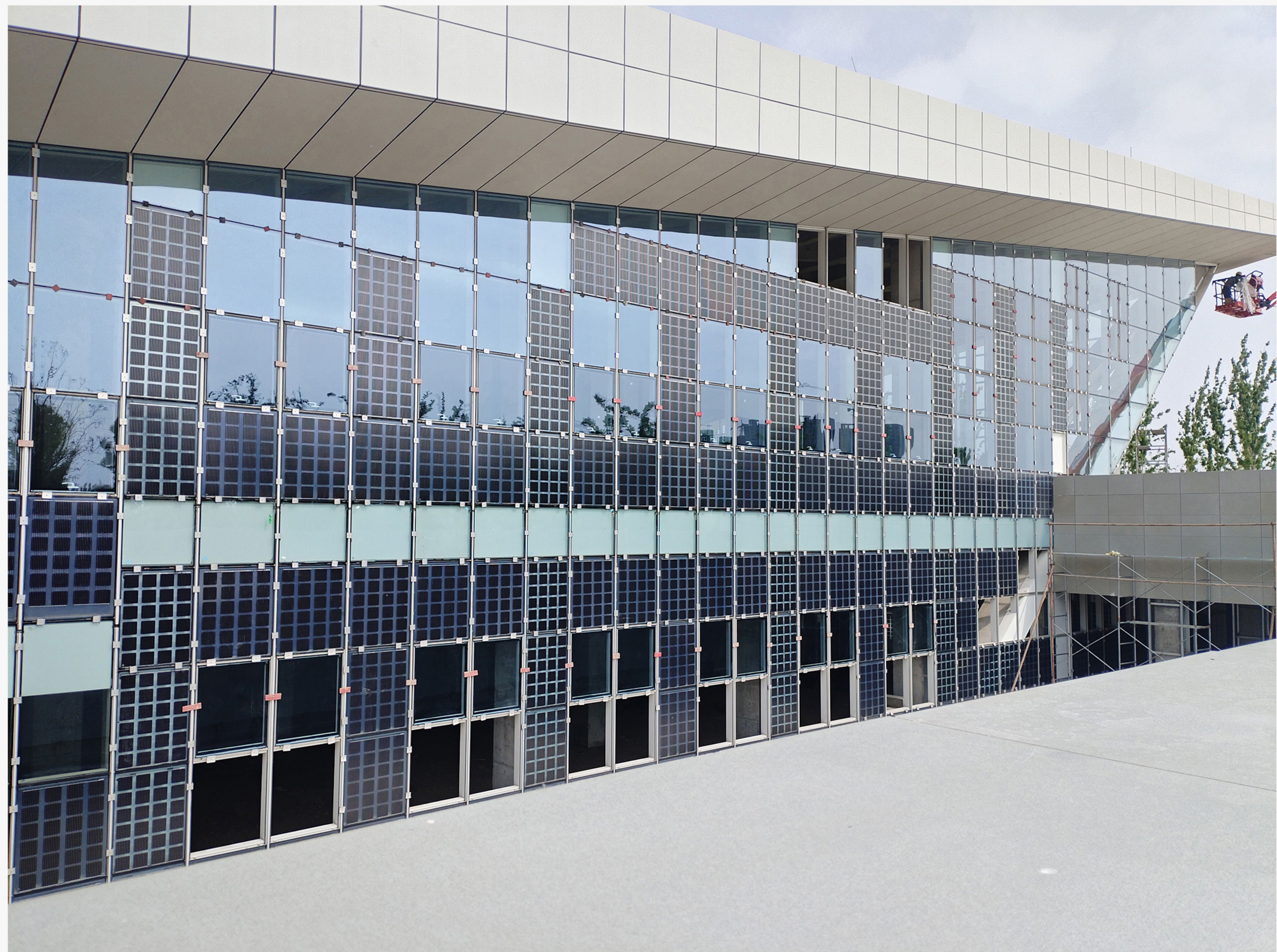
建筑一体化光伏幕墙 (安阳县中央水系幕墙项目)
