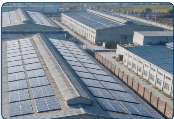
23 惠州天骏 1.3MW光伏项目
