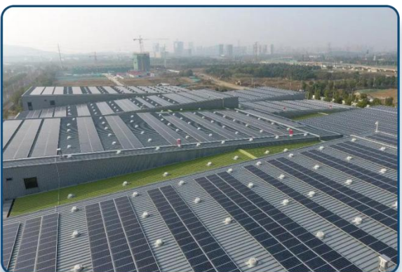
05 江豪集团有限公司 14MW光伏发电项目
