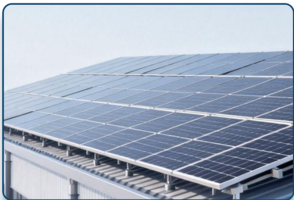
21 东莞常平杰威家具 330KW光伏项目
