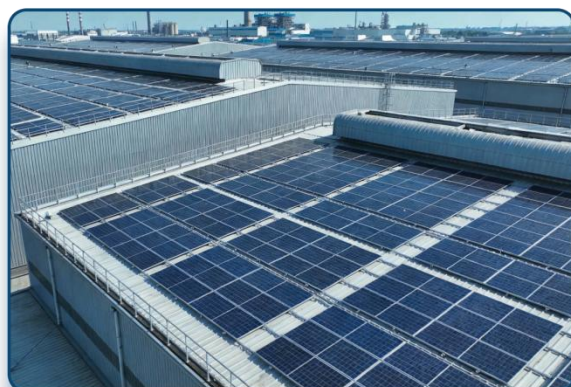
02 天津美亚化工 1.5921MW分布式光伏发电
