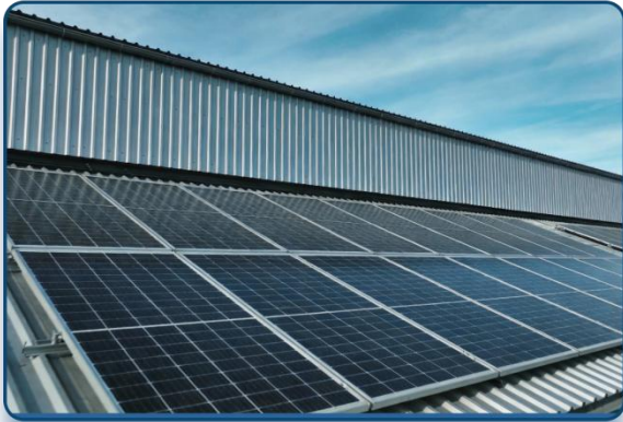
13 韶关市富田贸易有限公司 0.426MW分布式光伏
