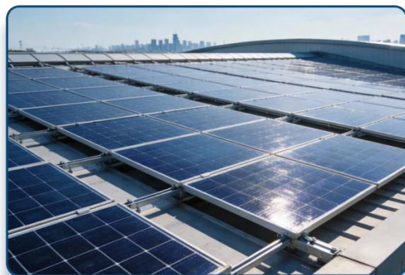
24 珠海墨美 0.9MW光伏项目
