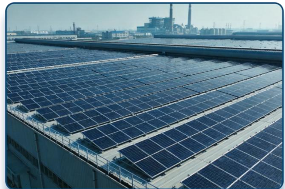
16 榆林市子洲县光伏项目 5MW光伏扶贫项目
