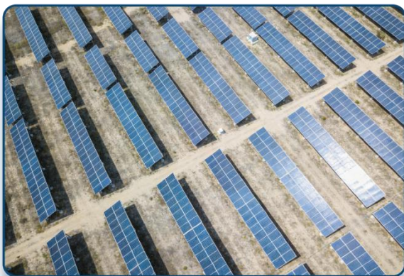
17 晨曦集团光伏发电项目 30MW地面电站项目小EPC
