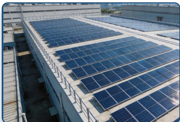
11 山东省鄄城县光伏扶贫项目 4MW光伏扶贫项目
