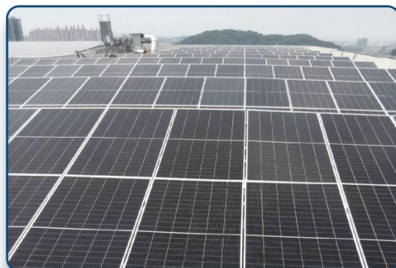
04 金马工业集团 13MW光伏发电项目
