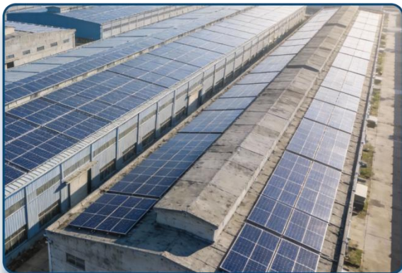
15 榆林市横山区光伏项目 2MW光伏扶贫项目
