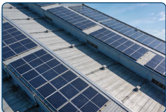
09 莒县瑞海三利金属制品公司 3.2MW光伏发电项目
