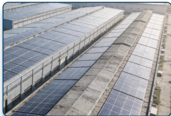
22 珠海兴信达 1.4MW光伏项目
