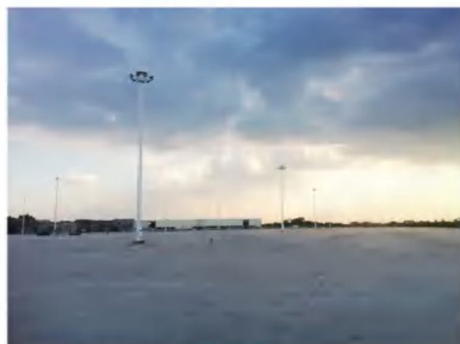
北汽广州分厂厂区高杆灯照明
