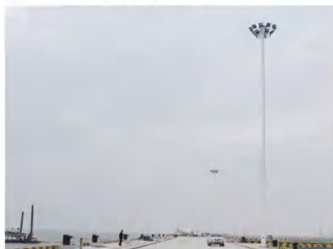
珠海高栏港高杆灯
