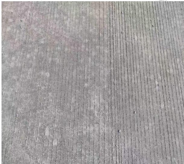
(a) 内掺 0.3%+外涂组表面无裂缝
