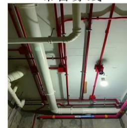
卫生间水电路
