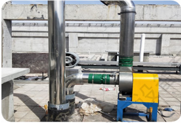
1. 管道抽风设备
