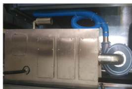
废气除臭装置
