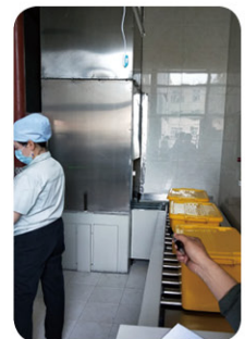
6. 医疗废物管道 落地总览
