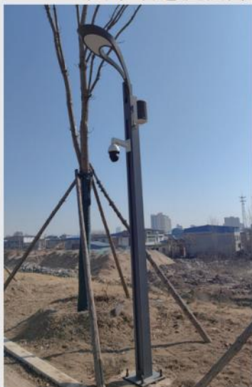
长廊-智慧庭院灯
