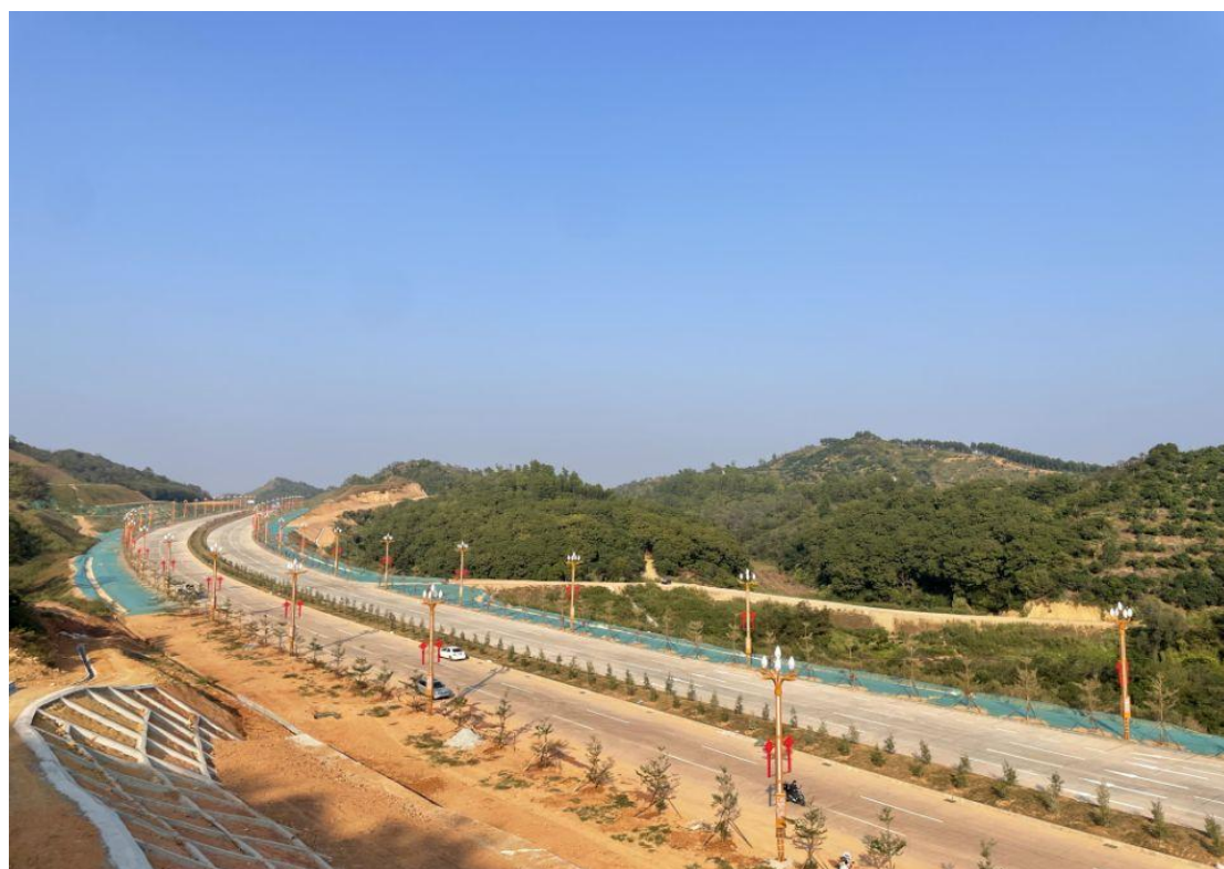
茂名高州永青大道路灯项目
