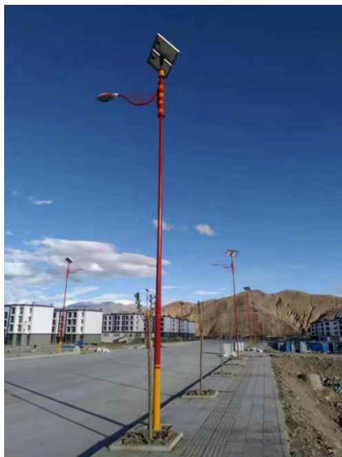
西藏自治区日喀则市太阳能路灯工程
