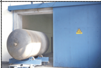
压力容器 X 射线探伤室
