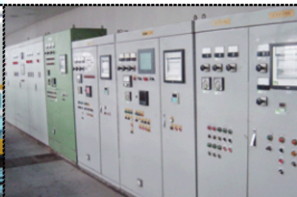
热处理控制室
