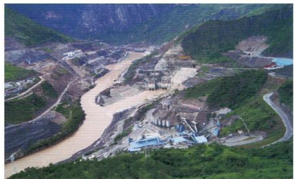
白鹤滩水电站
