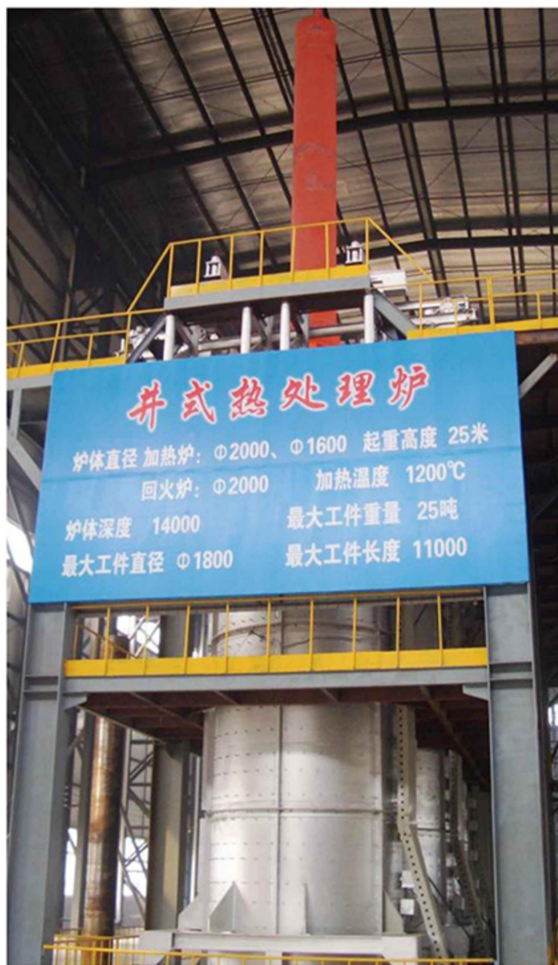
★主蒸汽无缝钢管热处理炉
