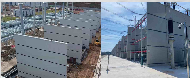
国网长沙1000kv特高压变电站（鲁班奖）
