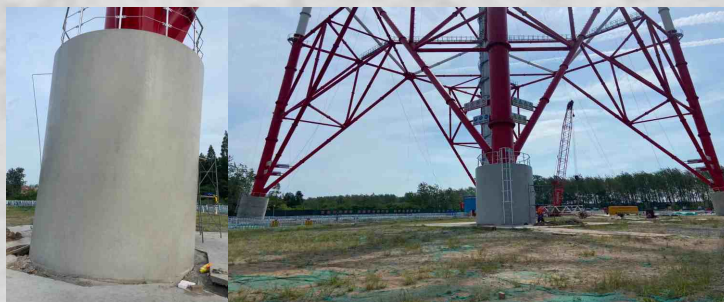
螺山长江特高压铁塔
