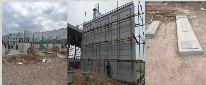
河北承德500变电站
