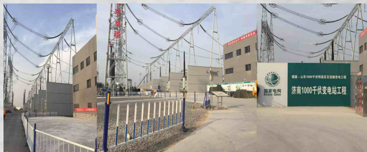
泉城1000千伏(荣获鲁班奖)
