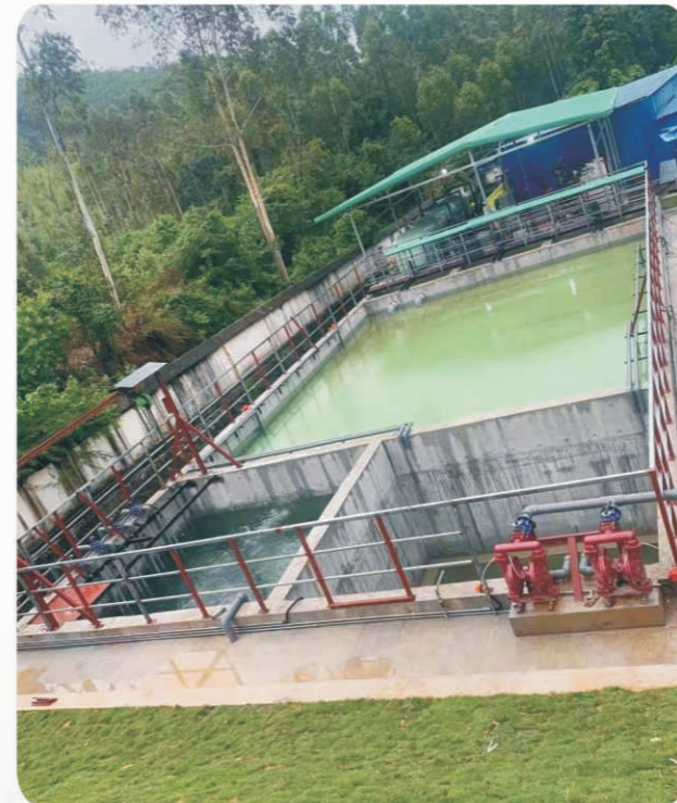
韶关鸿丰水泥污水处理站
