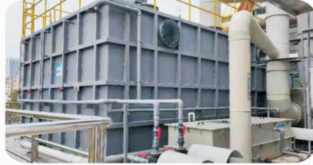
深圳光明生物除臭塔
