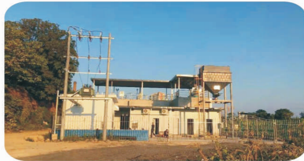
横沥村头应急污水处理项目
