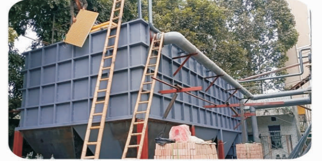
常平除磷一体化沉淀池
