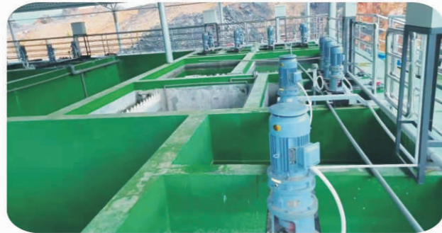
阳极氧化废水处理工程
