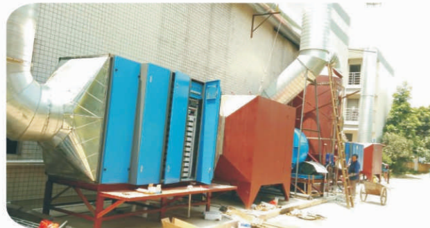
东莞市企浩项目废气治理工程
